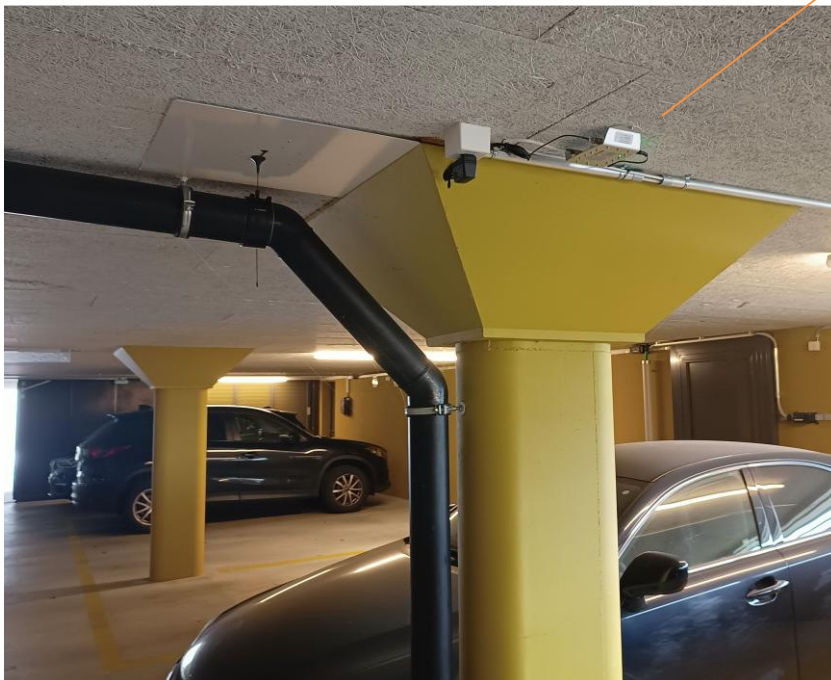
Innen: Das unauffällige DAB+ Repeatergerät und die diskret platzierte DAB Sendeantenne versorgen die gesamte Halle mit allen aussen empfangbaren Radioprogrammen.
