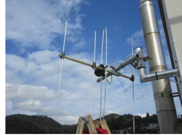
an einen vorhandenen Masten
